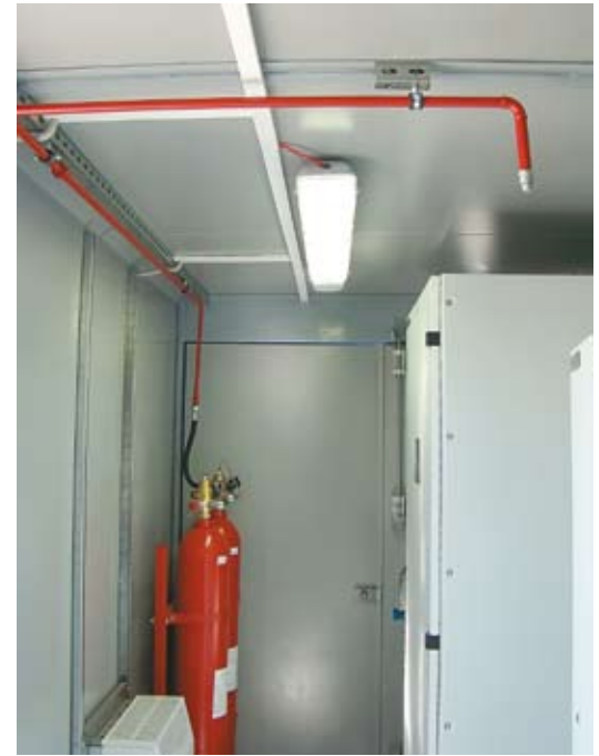
Система газового пожаротушения ТЕХНОС-М+в контейнере автономного источника питания
